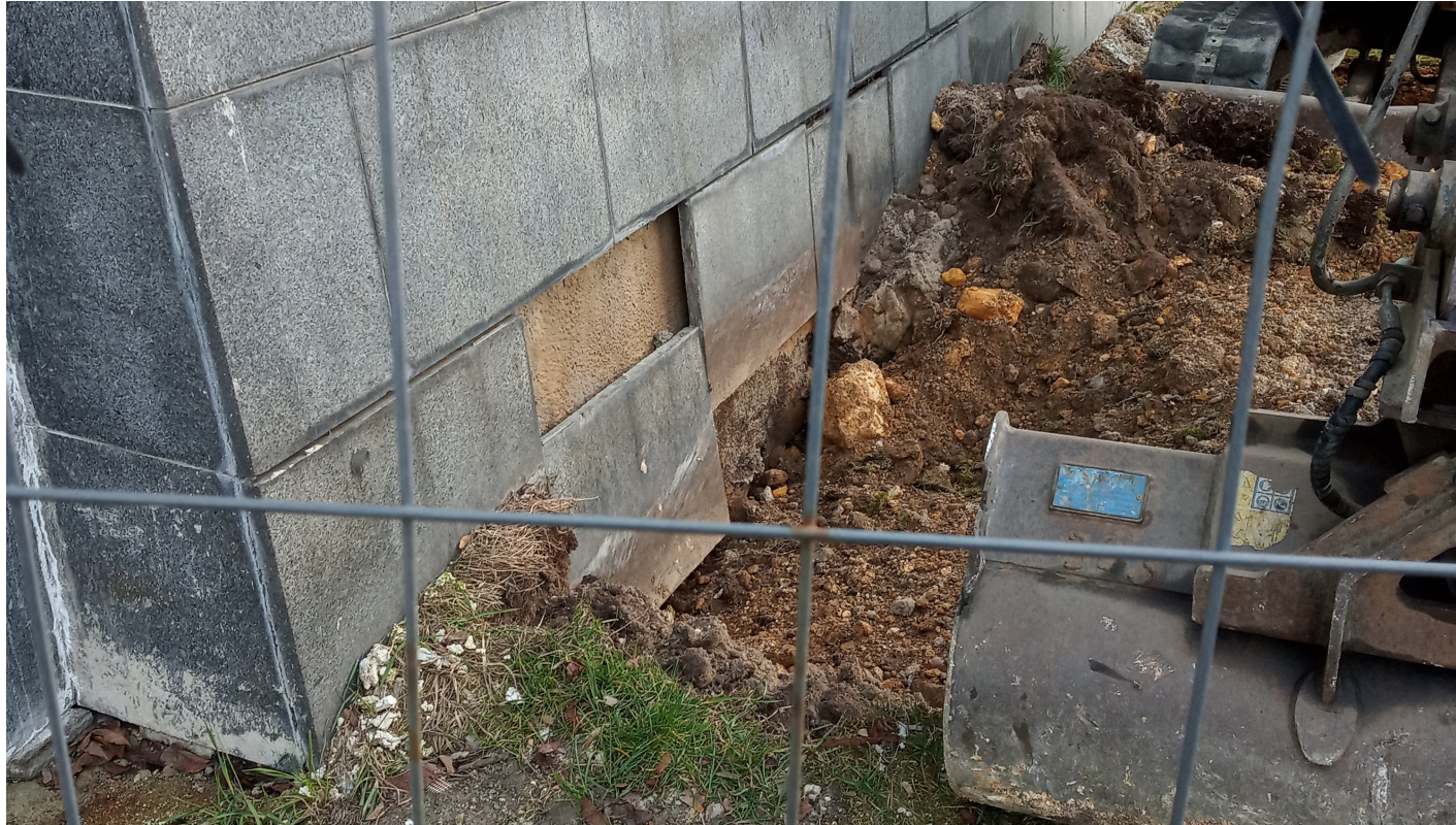
6/ Degradované materiály vyžadující rekonstrukci
