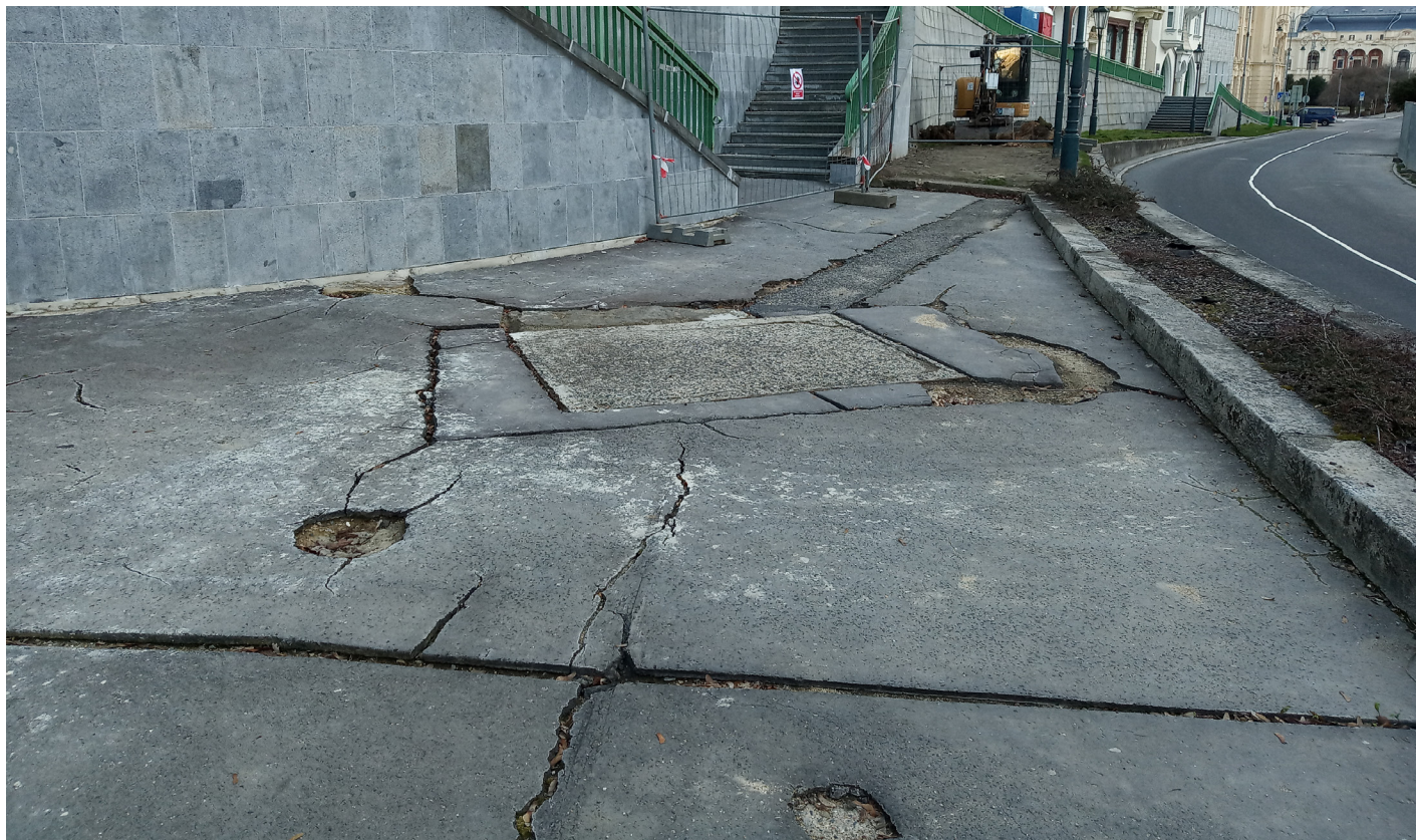
7/ Zcela degradované materiály povrchů
