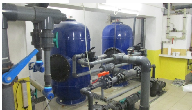
Úprava vody plaveckého bazénu
